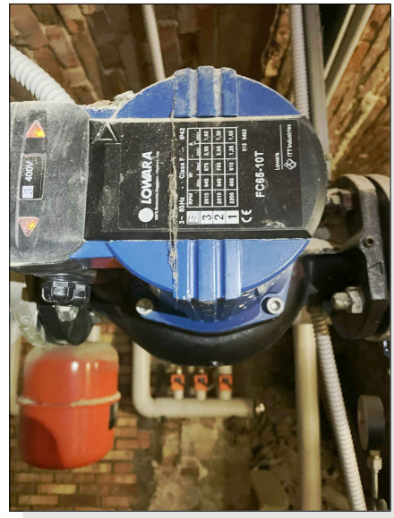
ELETTROPOMPA IN LINEA RISCALDAMENTO RADIATORI
