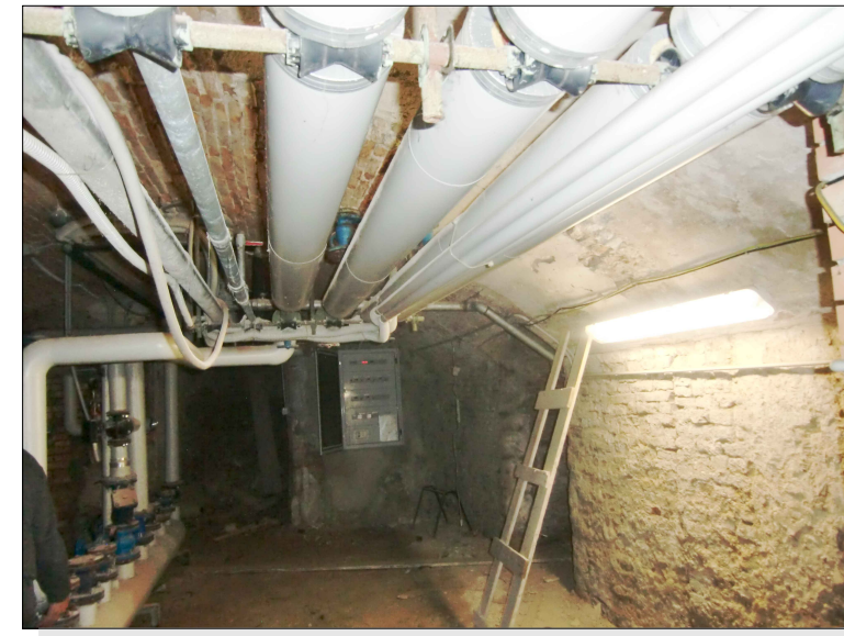
TUBAZIONI IN INGRESSO ALLA SOTTOCENTRALE
