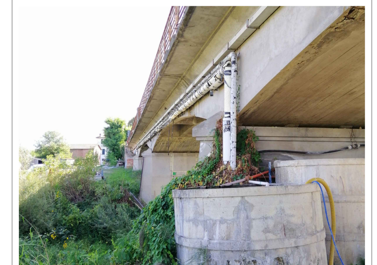
Foto tubazioni - lato valle
